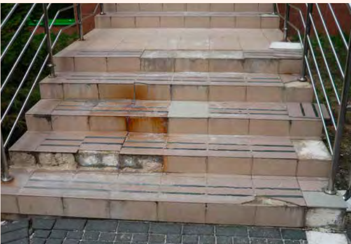
Ausblühungen und Haftverbundschäden aufgrund fehlender Abdichtung.
