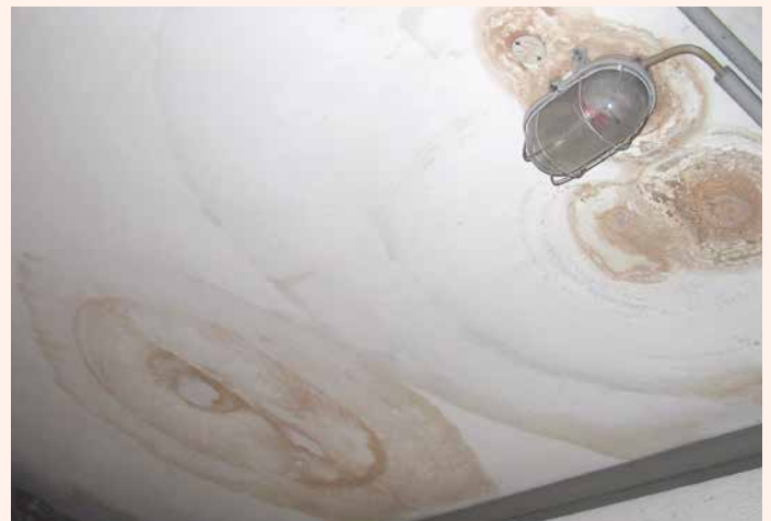
Feuchtigkeitsschaden an der Decke unter schadhafter Abdichtung.
