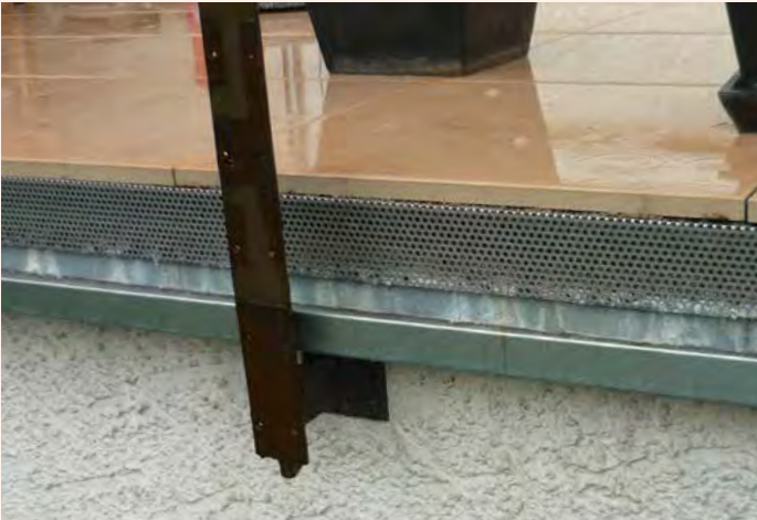
Ausblühungen aus einem nassen Estrich aufgrund fehlerhafter Balkonabdichtung.
