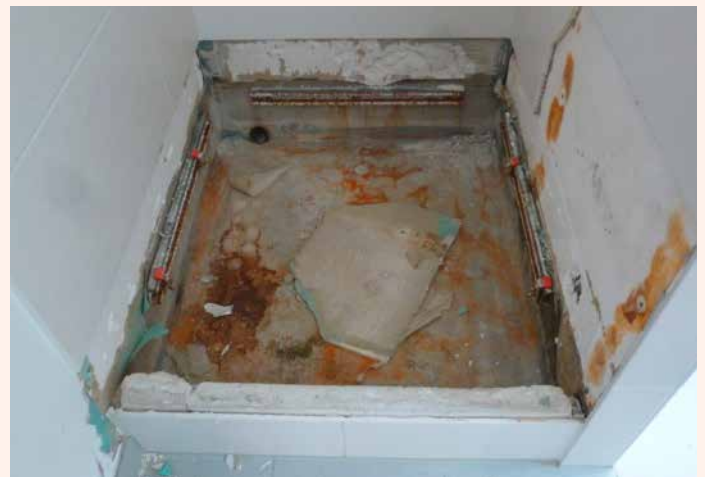
Beschädigte Verbundabdichtung im Duschbereich durch fehlerhafte Abdichtung.
