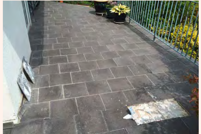
Beschädigter Fliesenbelag aufgrund fehlerhafter Balkonkonstruktion.
