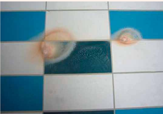
Ausblühungen im Schwimmbecken.
